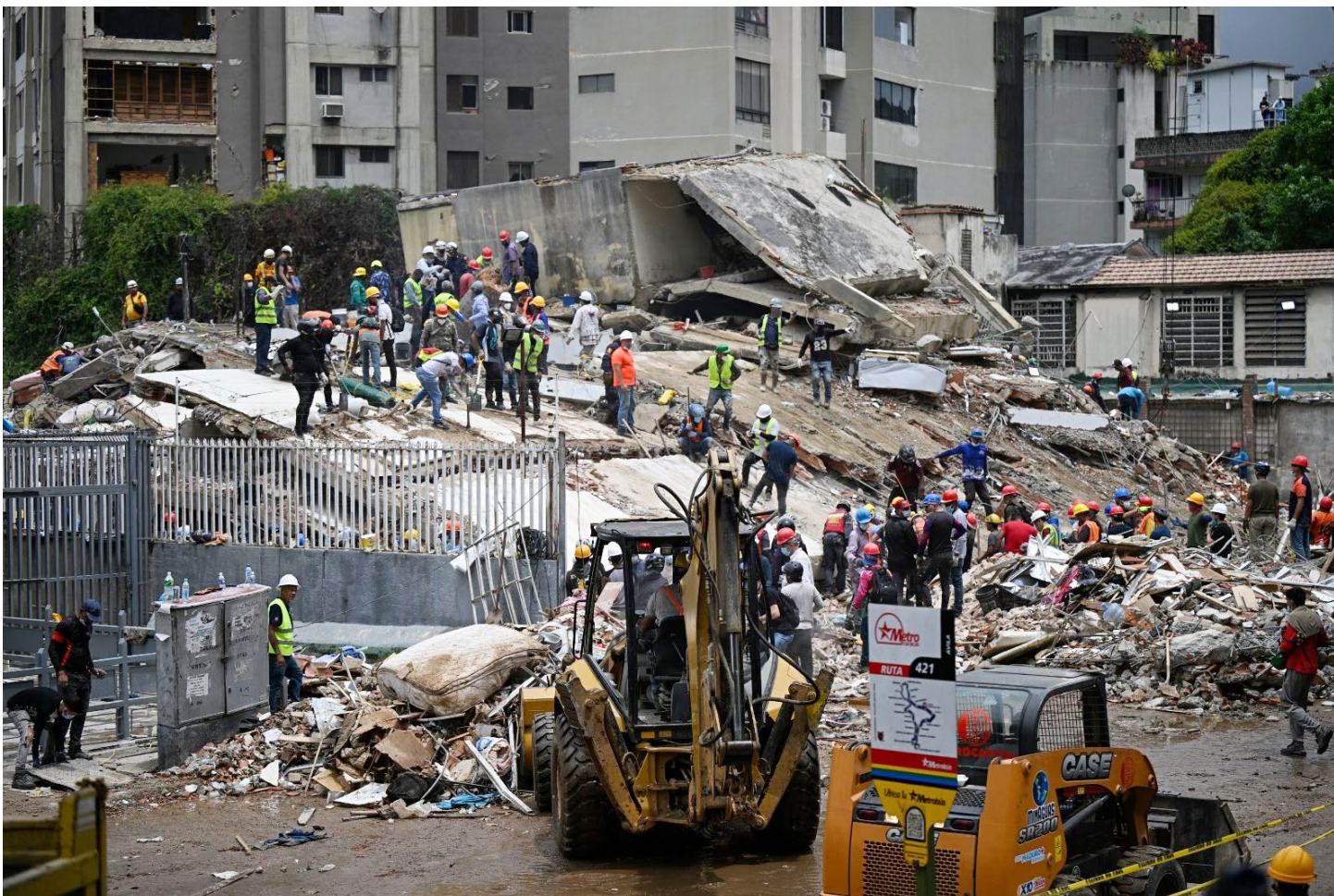
Trabajadores retiran escombros de un edificio colapsado en el barrio San Bernardino de Caracas, el 28 de junio. (AFP).
