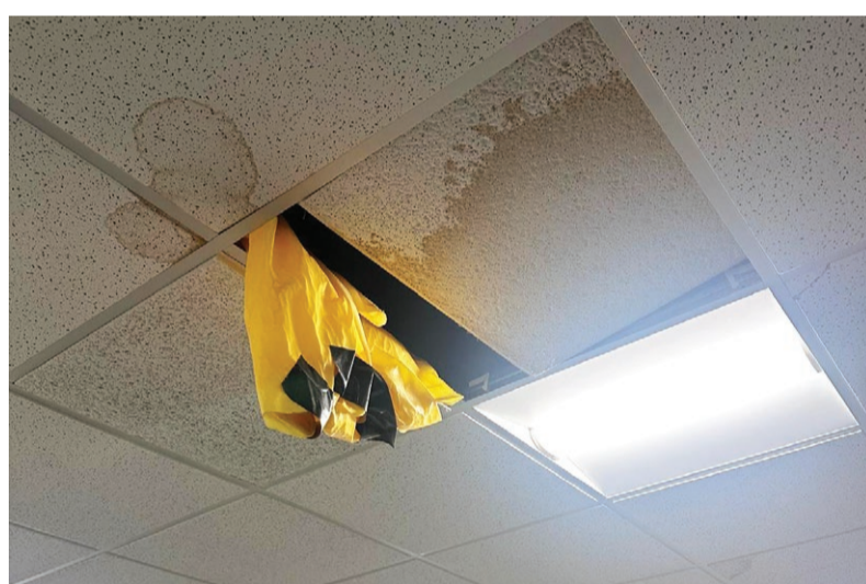
Filtración de agua de lluvia en un techo.
