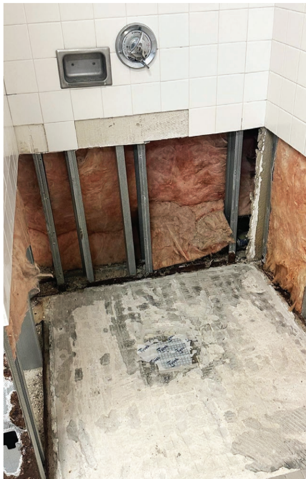
Un baño en mal estado. (FOTOS CORTESÍA POLICÍA DE MIAMI)
